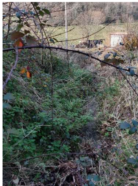
Vegetación acumulada en el cauce
