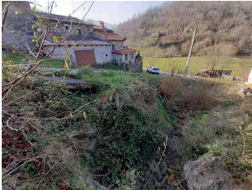
Desprendimiento de la margen izquierda del arroyo
